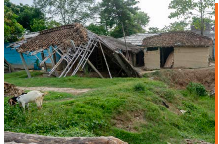
बाढीबाट क्षतिग्रस्त संरचना
